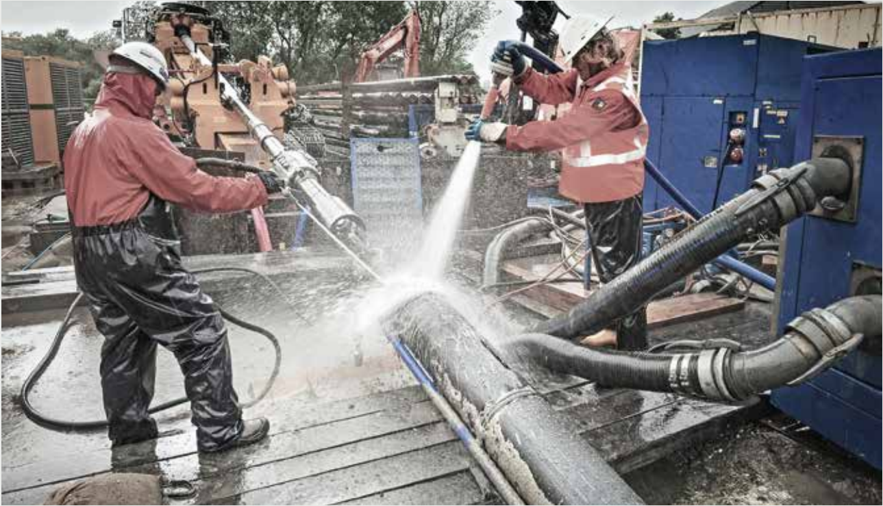
Im Jahr 2013 ging auf Borkum ein neues Seekabel ans Netz. Bild-Quelle: EWE NETZ GmbH
